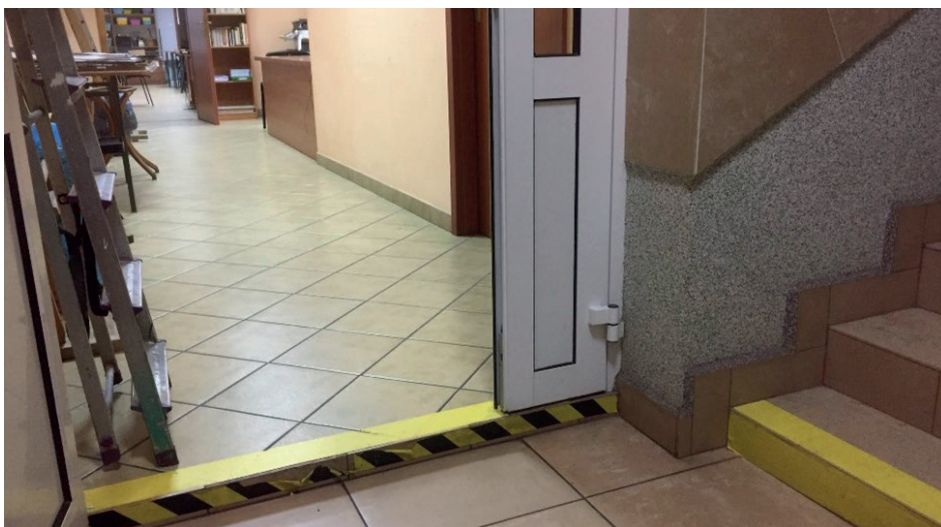
Audyty dostępności budynku – próg utrudniający poruszanie się osobom z dysfunkcją ruchu, dodatkowo przejście utrudnia umieszczona w ciągu komunikacyjnym drabina.
